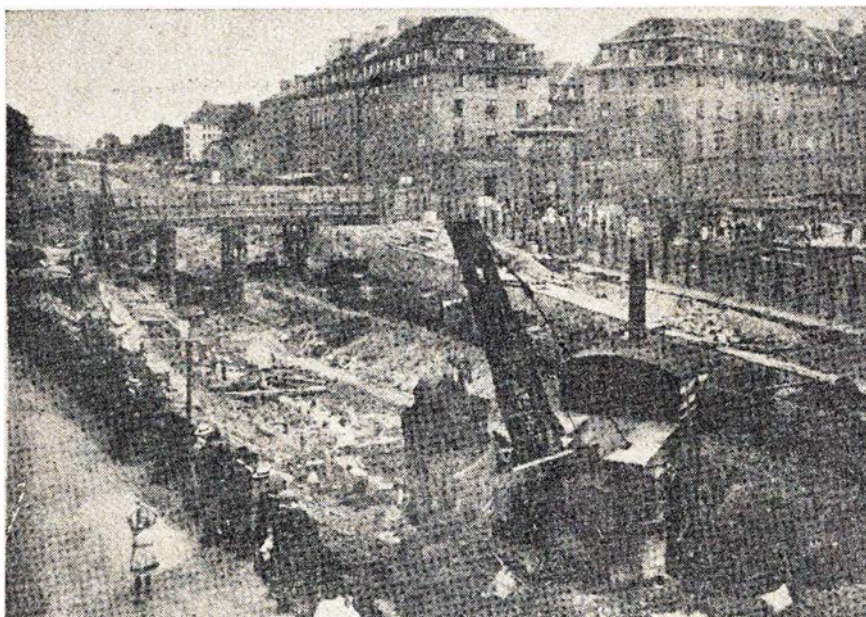
Gravearbejde ved Sølvgades kaserne, der dengang var infanterikaserne. DSB overtog først kasernen i 1928.
